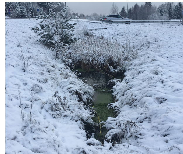
Dike som omhändertar dagvatten norr om väg 276
